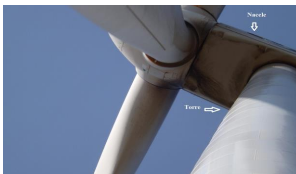
Figura 05: Torre eólica com marcas de vazamento de óleo
