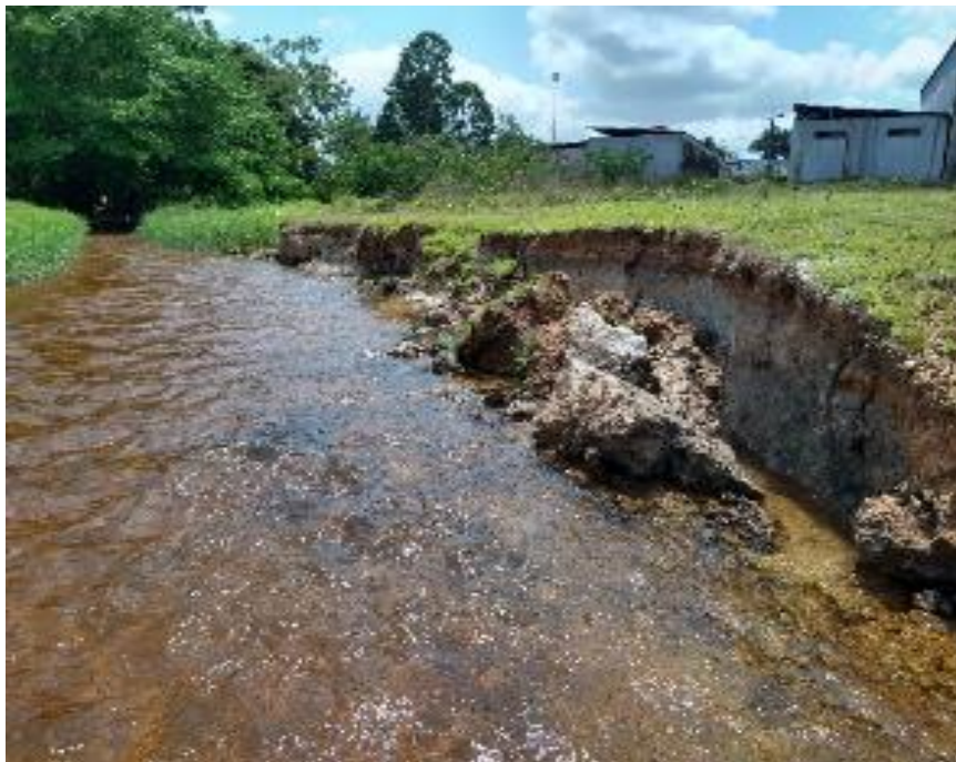
Figura 05 – Prédios e solo exposto com erosão na confluência do igarapé Garrafão com o rio Jipuíba, no bairro Centro
