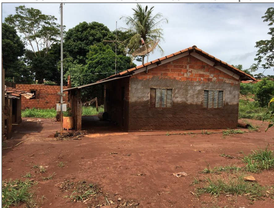
FIGURA 6: LIMITE ATINGIDO PELA ÁGUA DA INUNDAÇÃO
