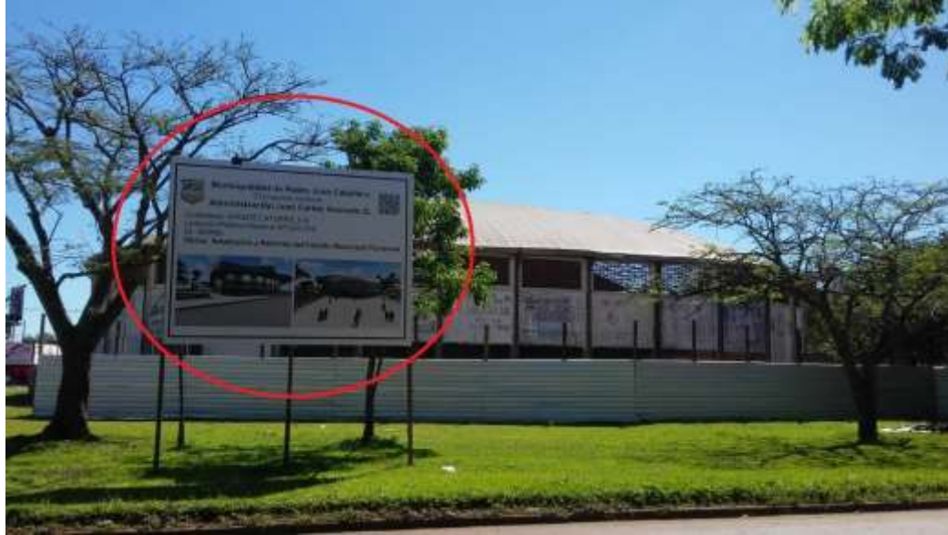
Fotografia 13. Placa de reforma do Estádio Municipal ao lado Laguna Punta Porã, PJC.
