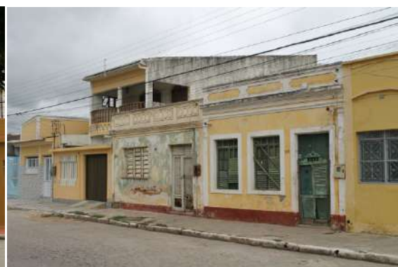
Figura 04 – Prédios abandonados. Centro Histórico de Pão de Açúcar Fonte: A Autora (2018)
