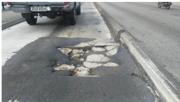
Figura 2 - Buraco na via próximo à Estação Tanque (Transcarioca)
