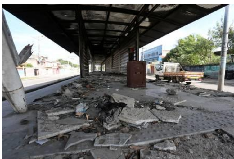
Figura 7 - Estação do BRT Cesário 3 (Transoeste) destruída. Fonte: FABIANO ROCHA / AGÊNCIA O GLOBO / JORNAL EXTRA, 2019.
