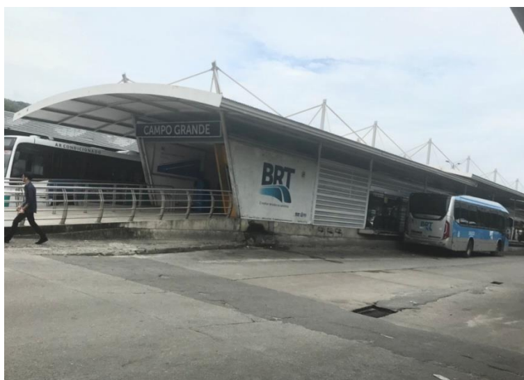
Figura 3 - Terminal Campo Grande e buraco no asfalto (Transoeste) Fonte: DA AUTORA, 2020
