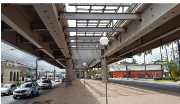
Figura 6. Elevado inacabado com parada inacabada na Avenida Caxangá Fonte: Autores (2017).
