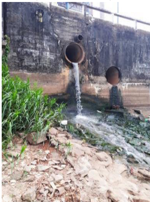
Figura 2 – Despejo do esgoto.
