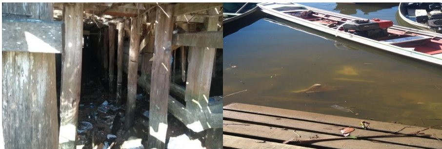
Figura 1: Imagens da área do trapiche no entorno da feira, mostrando a sujeira acumulada no local.
