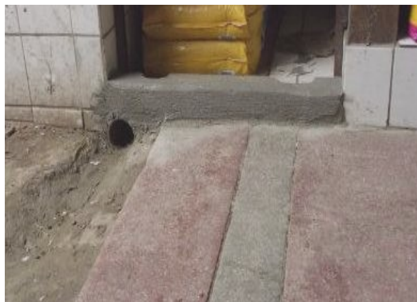
Figura 4 – Obstruções e barreiras de cimento
