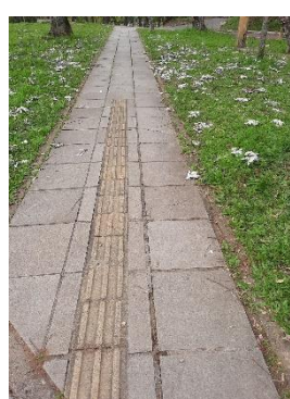
Figura 5 - Calçada próxima da entrada /saída do campus
