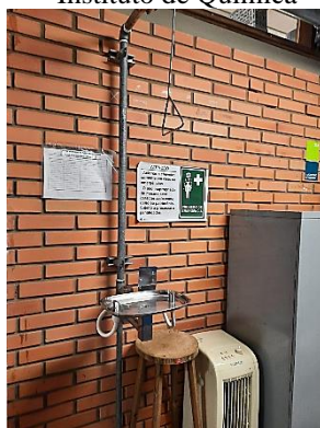
Figura 10 - Chuveiro de emergência
