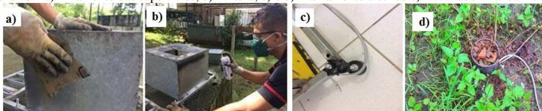
Figura 10 – a) Lixamento das superfícies; b) Pintura; c) e d) Aterramento elétrico e) Resultado final da máquina
