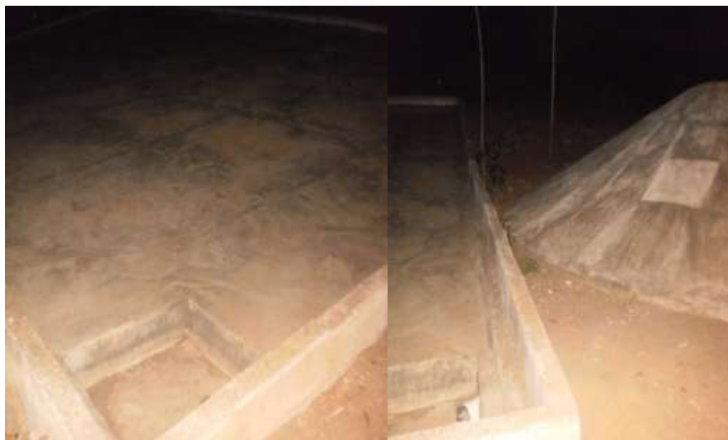
Calçadão e calçadão com cisternas de placas com capacidade para armazenar 52.000 litros,
