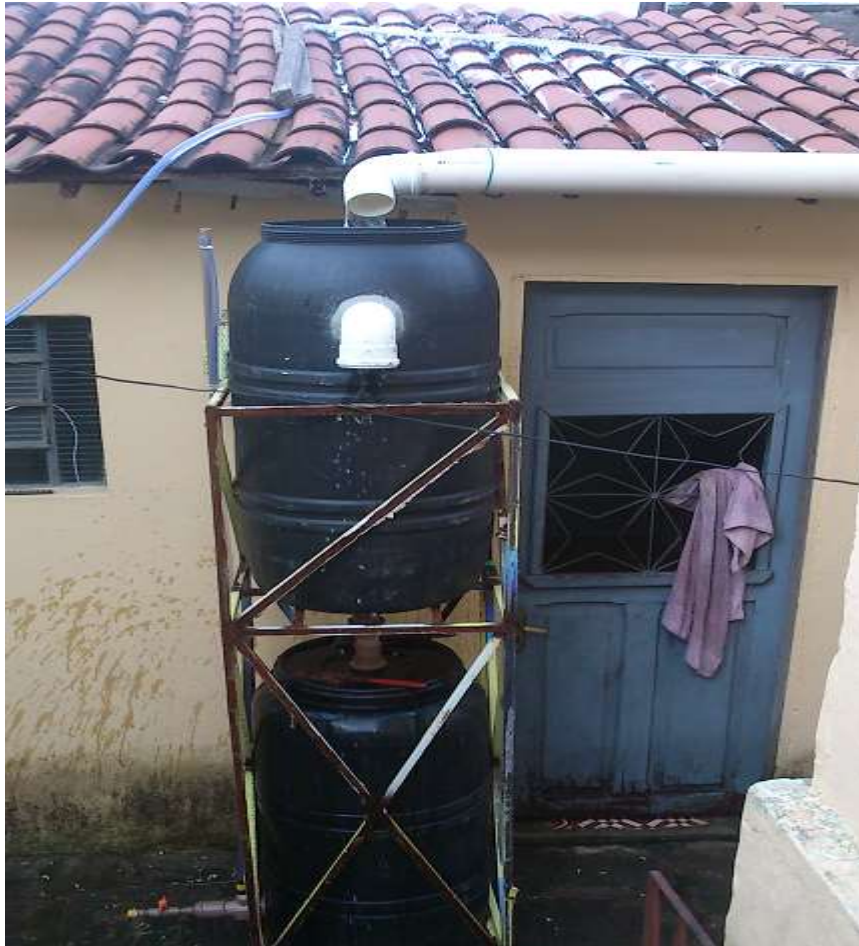
Figura 2. Foto do sistema PLUVIETA com capacidade de 500L
