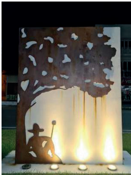
Figura 2 - Registro fotográfico da corrosão no monumento de ferro localizado na Avenida Getúlio Vargas na cidade de Pau dos Ferros-RN.
